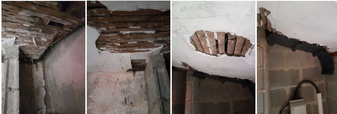
L'appenti (accolé à la maison) faisant office de local technique (arrivées eau et électricité) est très vétuste : plafond plâtre ruiné, morceau de zinc bricolé, présentant un risque de chute d'ouvrage/d'effondrement du plafond
