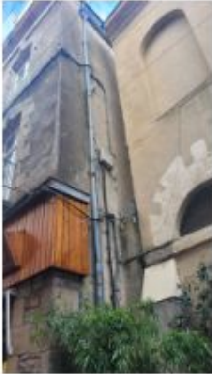
Réseau en façade et un réseau EU dans les EP
