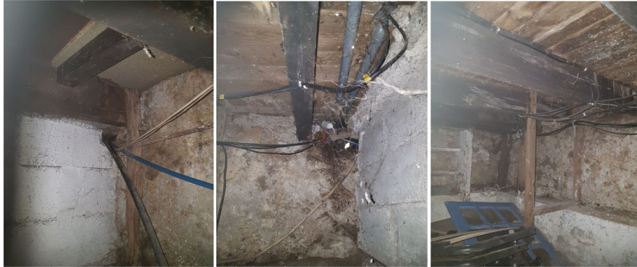
Réseau électrique d'allure anarchique en sous-face du plancher haut de sous-sol, câble électrique sectionné (fil dénudé). Raccordements bricolés de cette maison vers les deux autres du fond de parcelle.
