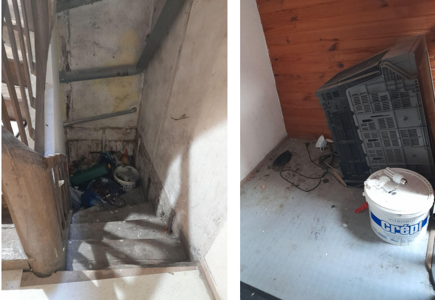
Encombrement des parties communes par des déchets (à gauche au RDC et à droite sur le palier du dernier étage)
