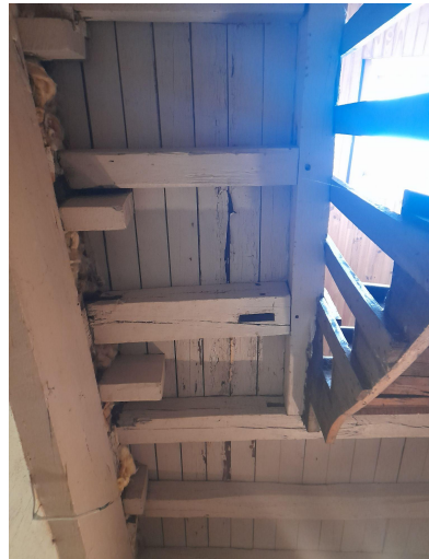
Plancher bois avec traces d'humidité suite aux dégâts des eaux récurrents lorsque l'occupant du dernier étage prend sa douche
