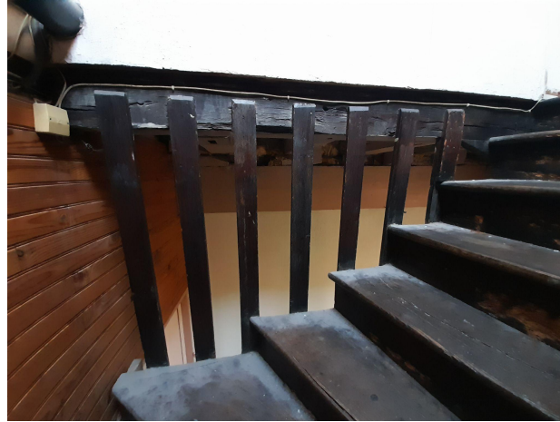
Dispositif anti-chute non-conforme (barreaudage supérieur à 11 cm)
