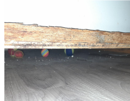
Douche posée sur une palette en bois insuffisamment renforcée
