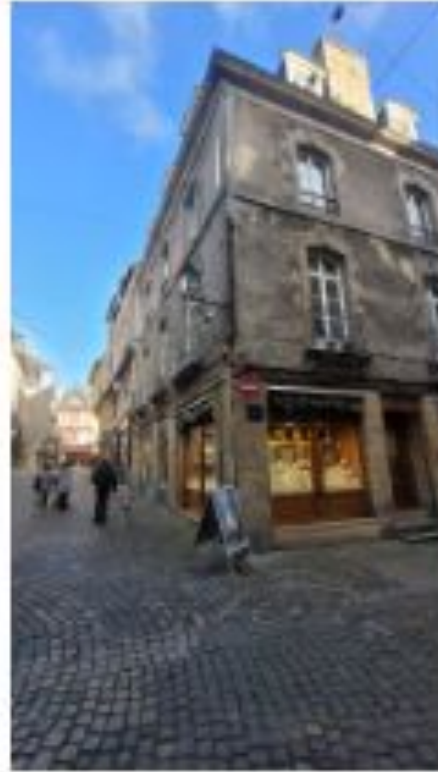
Enduits dégradés et fissuré
