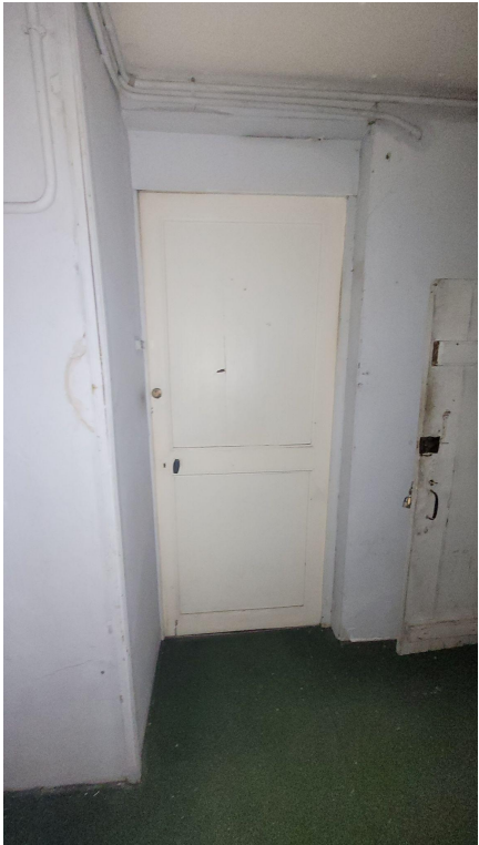
Porte d'entrée logement dégradée
