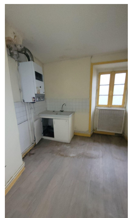
Logement insalubre à droite des escaliers avec forte présence d'humidité
