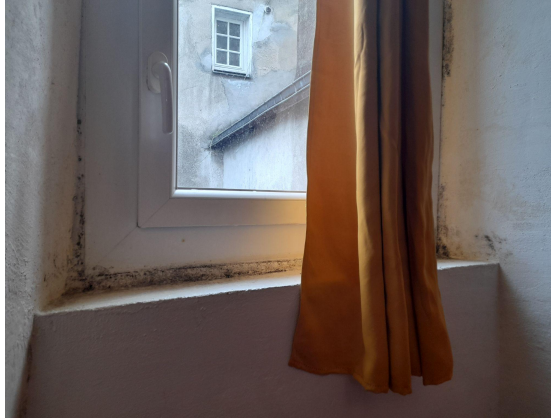
Traces d'humidité moisissures autour de la fenêtre
