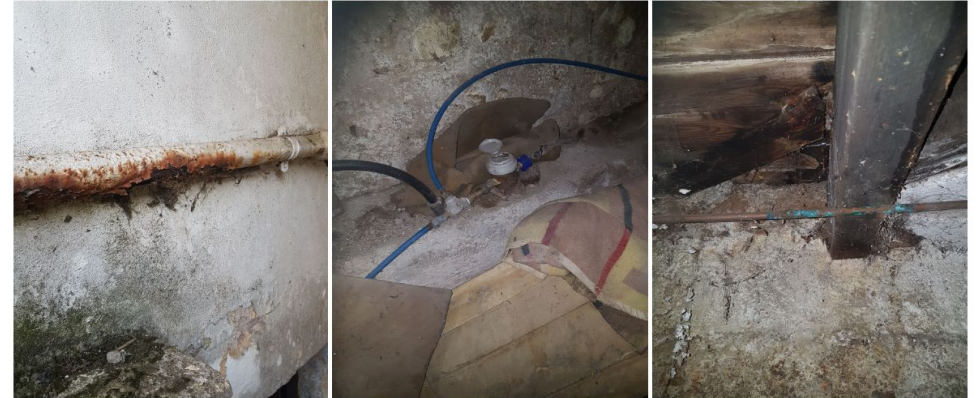
Ancienne canalisation métallique ruinée en façade (EU?), réseau anarchique en sous-sol, raccords douteux, état de dégradation avancé des canalisations.
