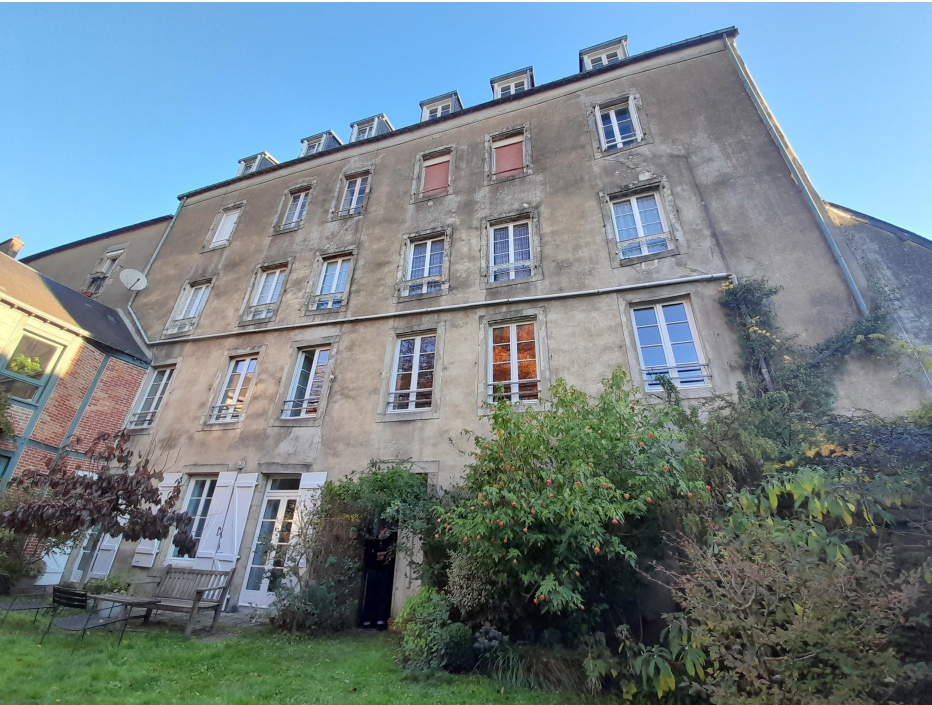
Façade sur jardin : stabilisation des fondations en rez-de-jardin + reprises structurelles (planchers/ouvertures) + ravalement + menuiseries et garde-corps
