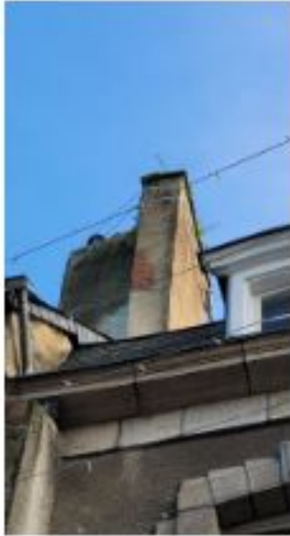
Souche de cheminée à revoir
