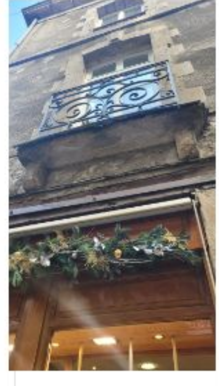
Descellement des balcons et de certaines pierres de façades
